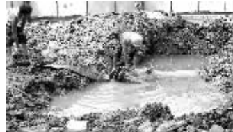
人民南路爆管现场
