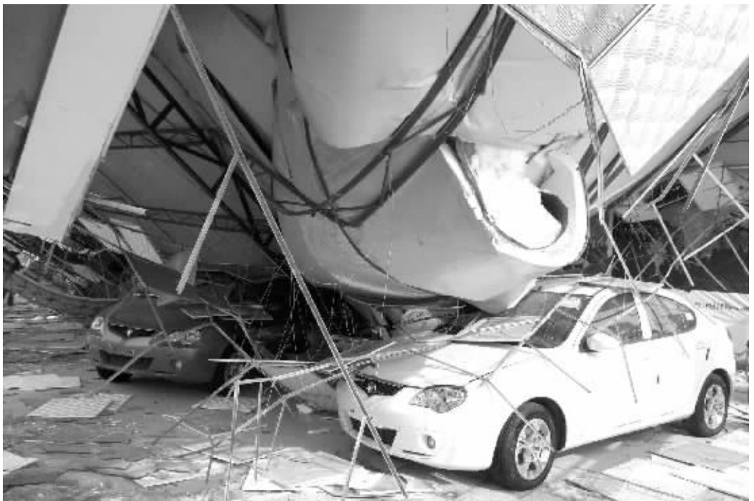
西安一汽车展厅房顶被积雪压塌 新华社发
