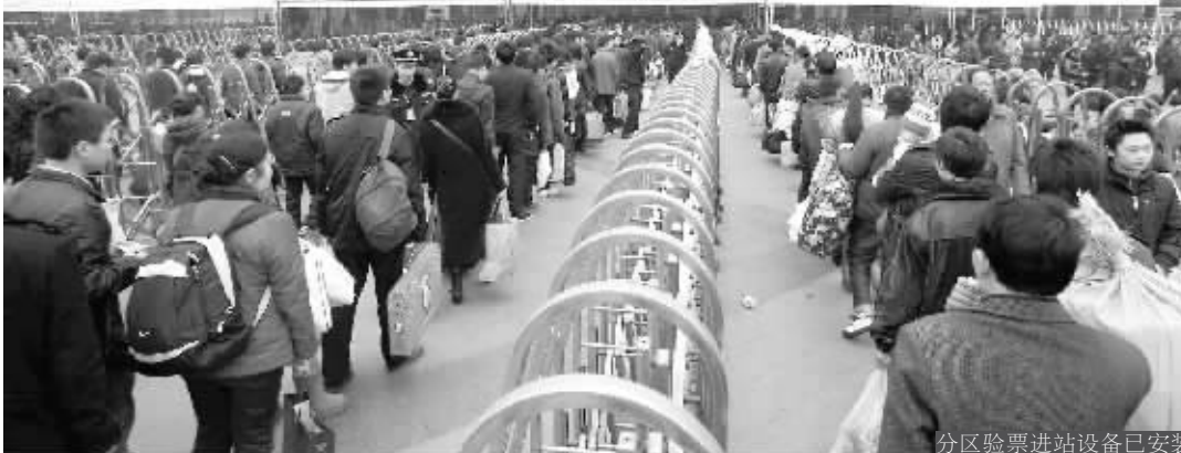
分区验票进站设备已安装
